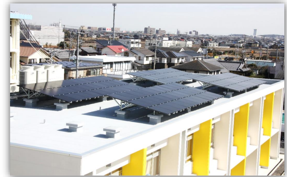
※ 稲生小学校の屋上に設置された太陽光パネル
