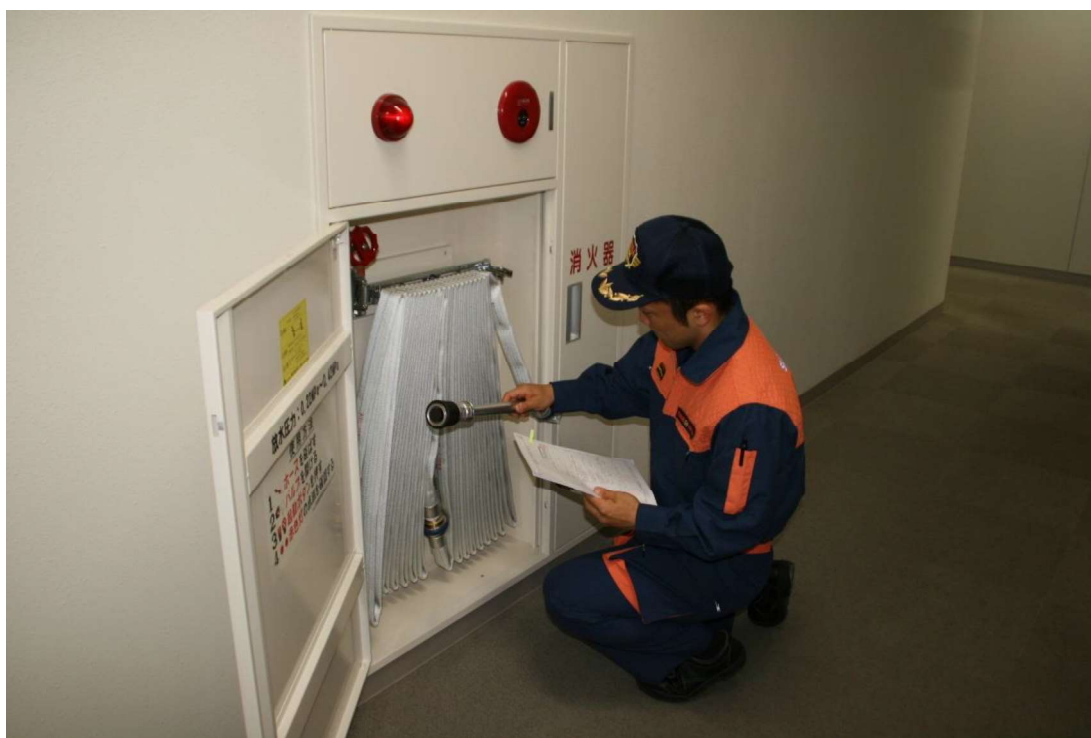
消防用設備検査
