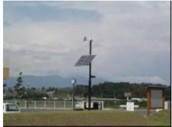
河川防災センターのハイブリッド照明灯 (太陽光発電と風力発電の組合せ)
