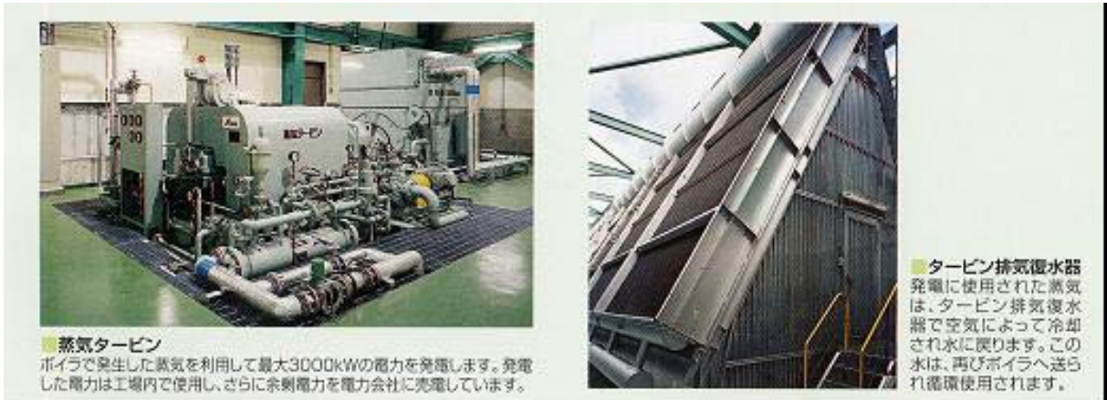
鈴鹿市清掃センターの廃棄物発電
