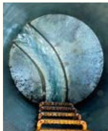
油で詰まった污水管
