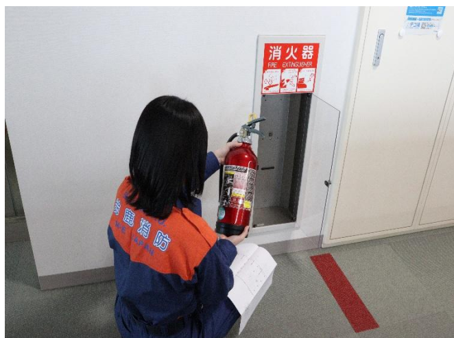
消防用設備検査
