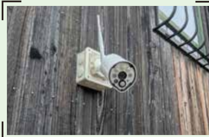
▲設置した防犯カメラ
