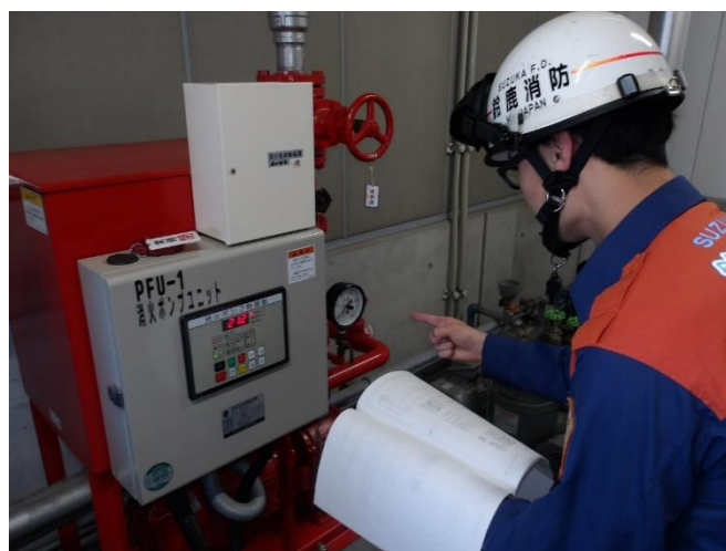
消防用設備検査
