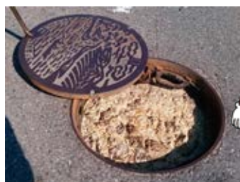
▲油で詰まったマンホール
