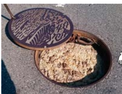
▲油で詰まったマンホール
