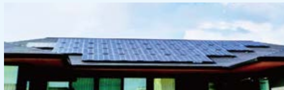
▲家庭用太陽光発電設備
