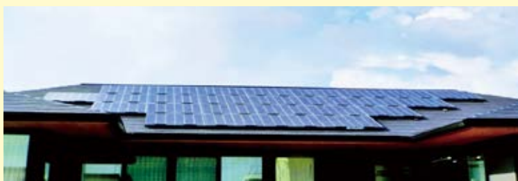
▲家庭用太陽光発電設備
