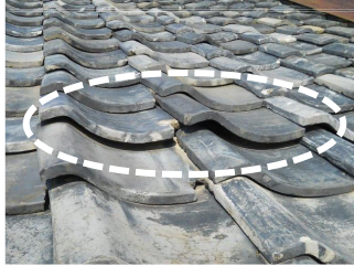
瓦に浮き上がりが生じている
