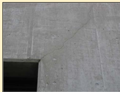
【コンクリートの乾燥収縮ひび割れ】
