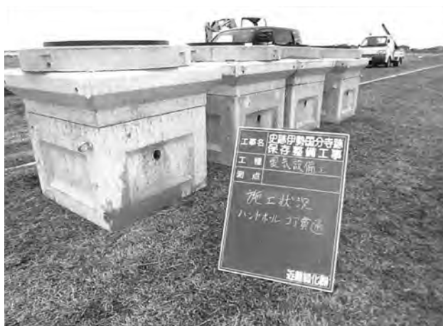
電気設備工 (給電用ハンドホール) (西南から)
