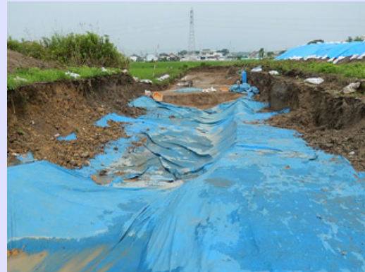
壁もセクションも崩壊。
