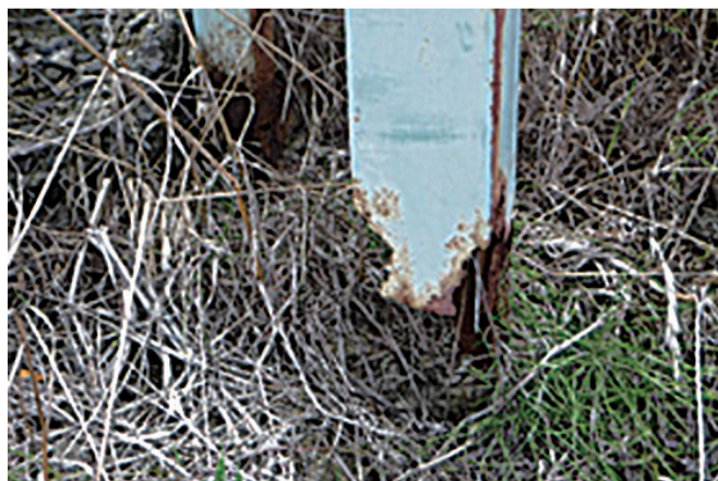
▲支柱基礎部の腐食
