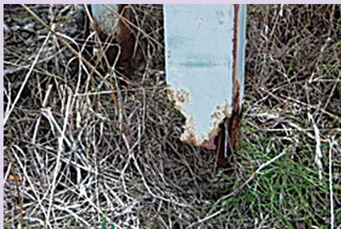
▲支柱基礎部の腐食
