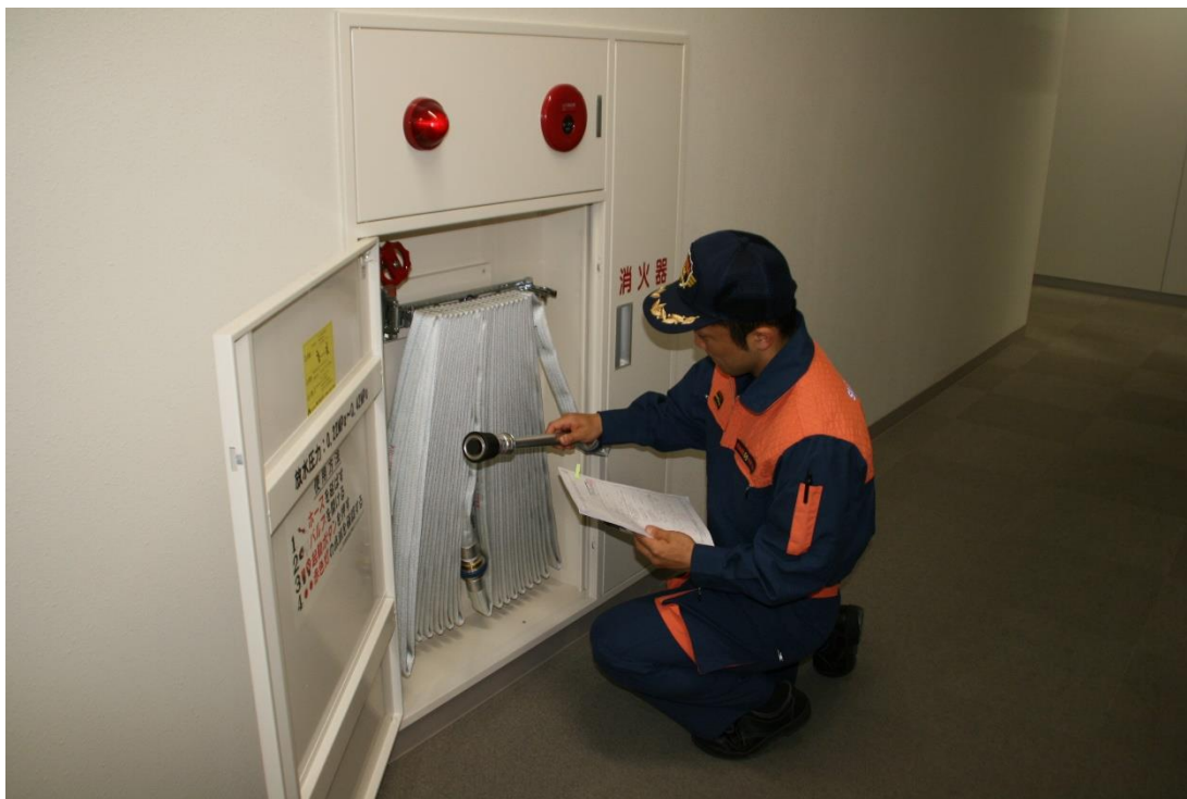
消防用設備検査
