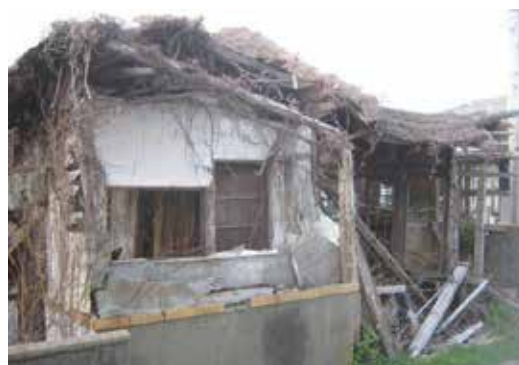
危険な空き家
