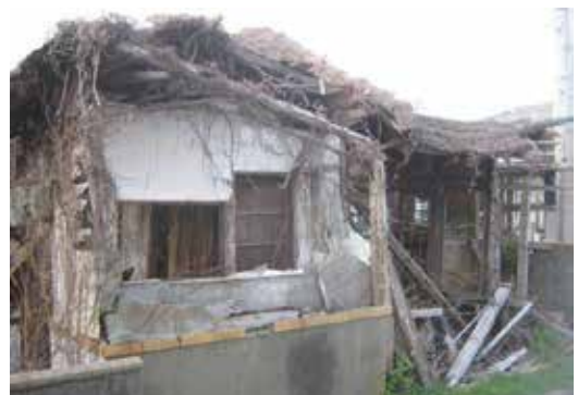
危険な空き家
