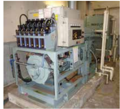
文化会館の非常用自家発電機
