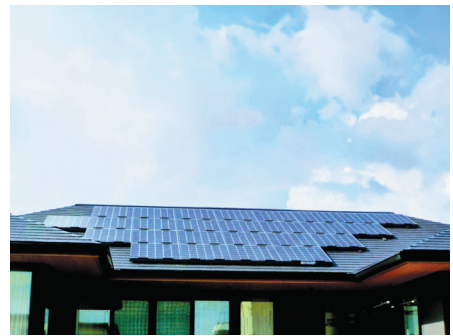
太陽光発電設備
