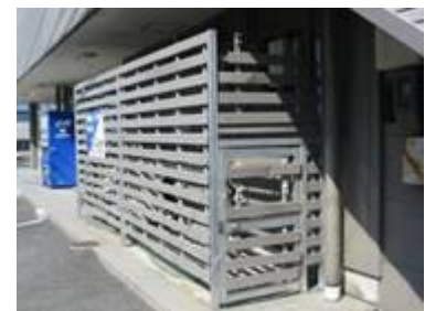
空調室外機等に囲いを設けて目立たないようにしている。
