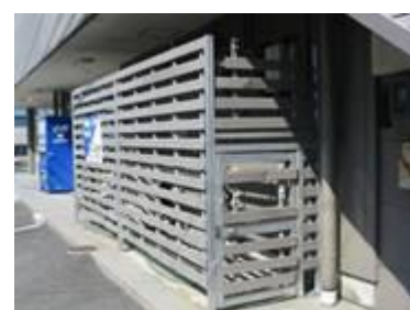
空調室外機等に囲いを設けて目立たないようにしている。
