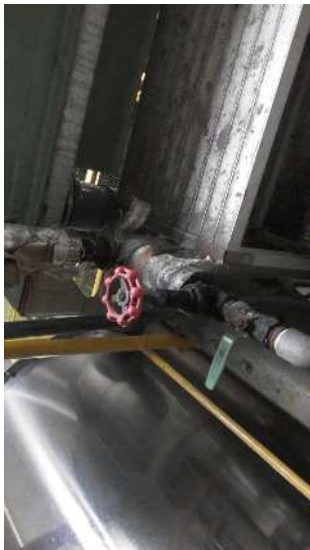
No. 2007 受入貯留設備 し尿用細目スクリーン バルブに腐食が見られるため 観察が必要。
