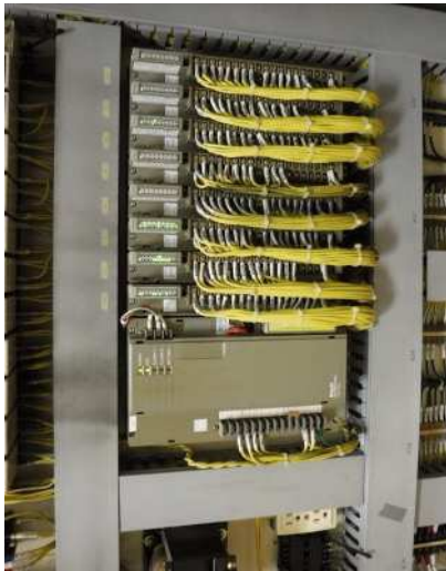
No. 3007 中央制御室 前処理・汚泥処理制御盤(2) 内部設置のシーケンサが耐用年数を越えていると思われるため、更新の検討が必要。
