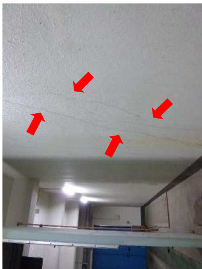
No. 1146 処理棟 1階 受入後室 ひび割れが見られる。
