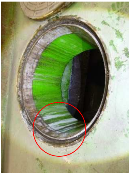
No. 1013 1階 投入室 し尿貯留槽 マンホール (内壁・投入前室側) マンホール枠や開口周囲の表面の防食の一部に汚損が見られる。
