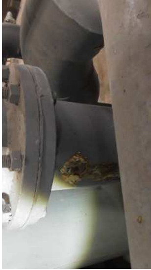
No. 2022 高度処理設備 砂ろ過器 本体に腐食が見られるため補修が必要。
