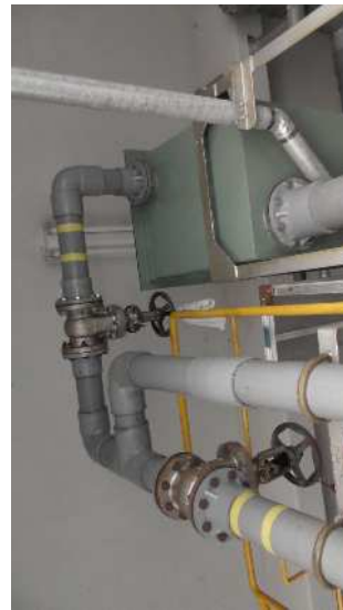
No. 2009 受入貯留設備 浄化槽汚泥用細目スクリーン フランジ部及びバルブに腐食 が見られるため観察が必要。
