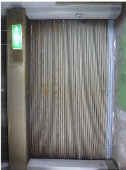
No. 1175 処理棟 1階 管廊 建具：内部シャッター 錆、塗装、劣化
