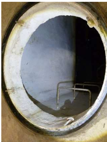
No.1055 2階 処理室 砂ろ過原水槽B マンホール（西側） マンホール枠や表面に全体的 な白い堆積物があるが、特に異 常は見られない。
