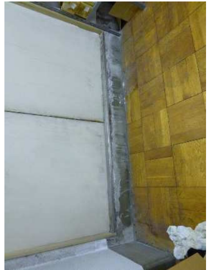
No. 1165 処理棟 2階 電気室 外部建具の足元からの漏水跡が見られる。
