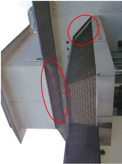
No. 1259 管理棟 屋根庇仕上げ面 (東側) 屋根葺き材の一部に汚れや劣化が見られる。 (3階玄関廻り他)
