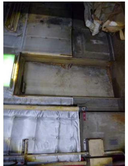
No. 1177 処理棟 2階 乾燥焼却炉室 内部扉の劣化が見られる。
