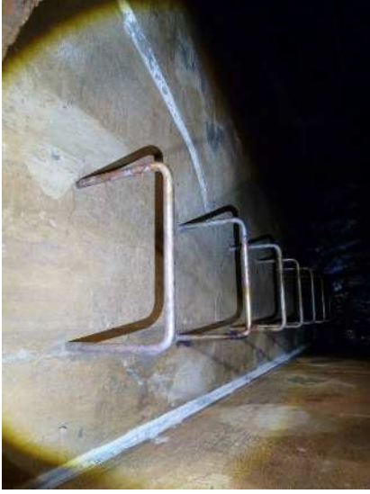
No. 1064 2階 処理室 活性炭処理水槽 水槽 (東側) 水槽内に特に異常は見られない。 タラップ各所に全体的な錆の発生がみられる。
