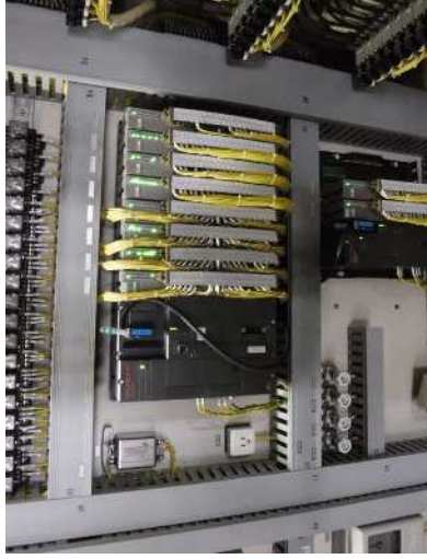
No. 3011 処理室 No. 1 高度処理制御盤 (P-4) 内部設置のシーケンサが耐用年数を越えていると思われるため、更新の検討が必要。
