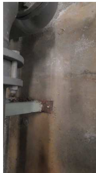
No. 2021 高度処理設備 砂ろ過器 サポート台に腐食が見られるため点検が必要。
