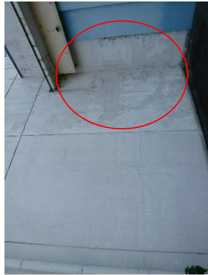
No. 1225 処理棟 外壁（南面） （投入前室廻り） 外壁に塗装の剥がれや劣化が見られる。
