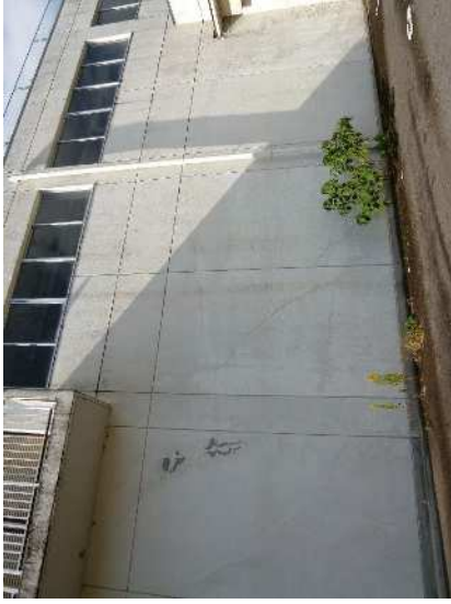
No. 1214 処理棟 外壁（東面） （第2曝気槽廻り） 外壁にひび割れが広範囲で見られる。一部に塗装の剥がれが見られる。
