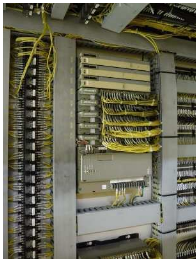
No. 3008 中央制御室 前処理・汚泥処理制御盤(3) 内部設置のシーケンサが耐用年数を越えていると思われるため、更新の検討が必要。
