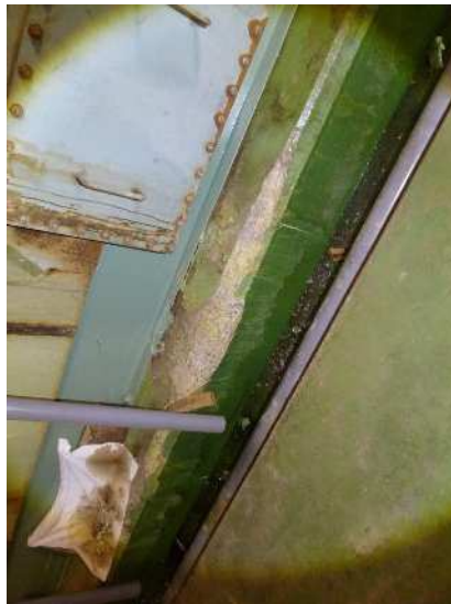
No. 1150 処理棟 2階 脱臭室 (13-16 通り間) 床面 機械基礎に欠けや劣化が見ら れる。(脱臭用活性炭吸着塔)
