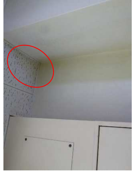
No. 1180 管理棟 3階 水質試験室 天井面に変色跡が見られる(屋 根からの漏水のおそれ)
