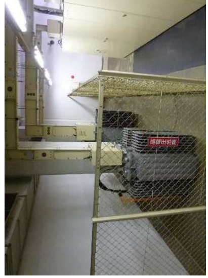
No. 1168 処理棟 2階 電気室 天井スラブ面（直天）の筋やしお状の形跡が見られる箇所の近傍の現況。（高圧系機器の設置あり）
