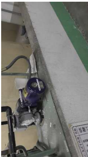
No. 2019 高度処理設備 硫酸バンドポンプ (No.2) 液漏れが見られるため点検が必要。
