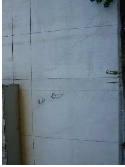
No. 1215 処理棟 外壁（東面） （第2曝気槽廻り） 外壁にひび割れが広範囲で見られる。一部に塗装の剥がれが見られる。
