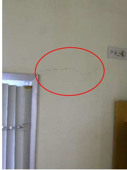
No. 1179 管理棟 3階 水質試験室 外壁面にひび割れが見られる。 (コンクリート壁。ひび割れは 窓の両側共に見られる)
