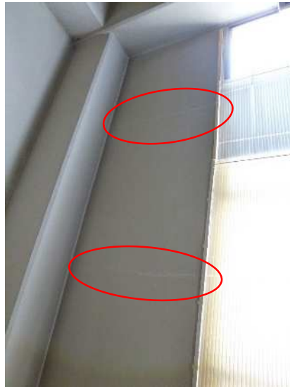
No. 1164 処理棟 2階 電気室 外壁面にひび割れが見られる。
