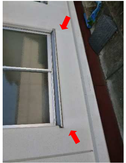
No. 1261 管理棟 3階ペランダ (北側) 外壁窓廻りの腰壁にひび割れが見られる。 (同上の拡大部)
