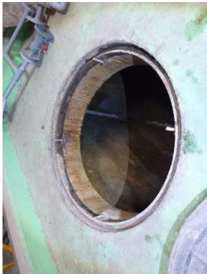
No.1058 2階 処理室 活性炭処理水槽 マンホール（北側） マンホール枠や防食の表面に 錆や汚損が見られる。
