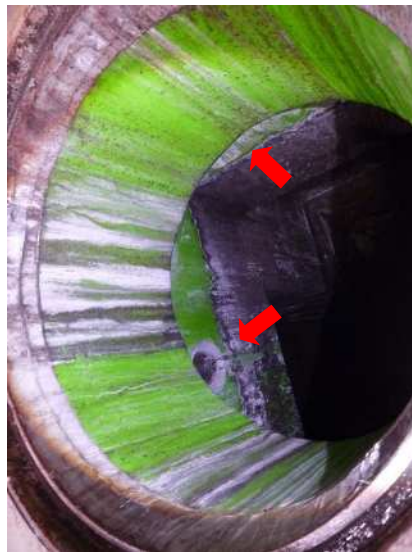
No. 1014 1階 投入室 し尿貯留槽 水槽 (内壁・投入前室側) 水槽の一部に汚損が見られる。
