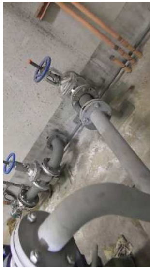
No. 2014 受入貯留設備 し尿攪拌ポンプ
