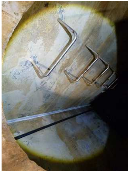
No. 1062 2階 処理室 活性炭処理水槽 マンホール (西側) 水槽内に特に異常は見られない。
