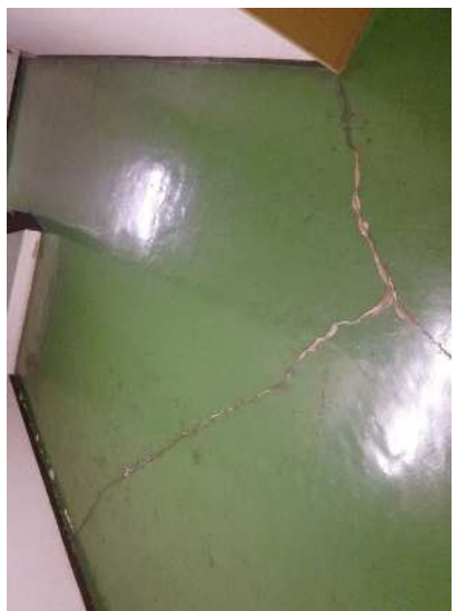
No. 1147 処理棟 B階段 (1階E V前) 床面のひび割れが見られる。 (塗床仕上げ)
