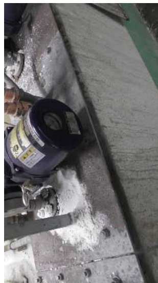
No. 2020 高度処理設備 犠牲ソーダポンプ 液漏れが見られるため点検が必要。
