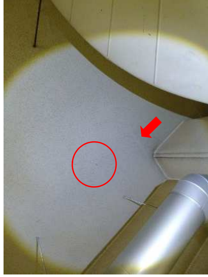
No. 1167 処理棟 2階 電気室 天井スラブ面（直天）に筋状やしお状の形跡が見られる。（9-10 通り間。上部はテニスコート沿いの屋外通路に該当。電気室内には高圧系の機器が設置されている）
