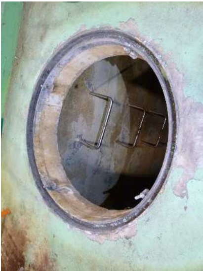
No. 1061 2階 処理室 活性炭処理水槽 マンホール (西側) マンホール枠に全体的な錆の発生がみられる。
