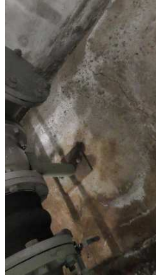
No. 2024 高度処理設備 逆洗ポンプ サポート台に腐食が見られるため補修が必要。
