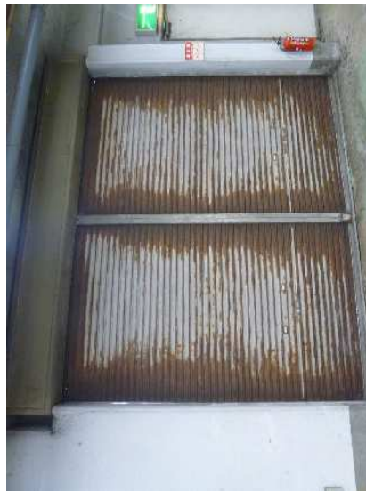
No. 1176 処理棟 2階 処理室 建具：外部シャッター 錆、塗装、劣化
