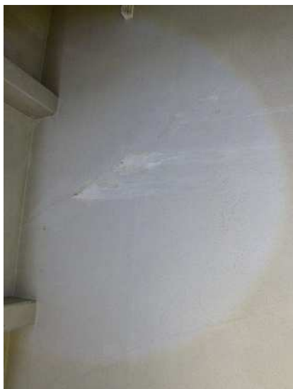
No. 1145 処理棟 1階 受入前室 ひび割れやエフロレッセンス が見られる。
