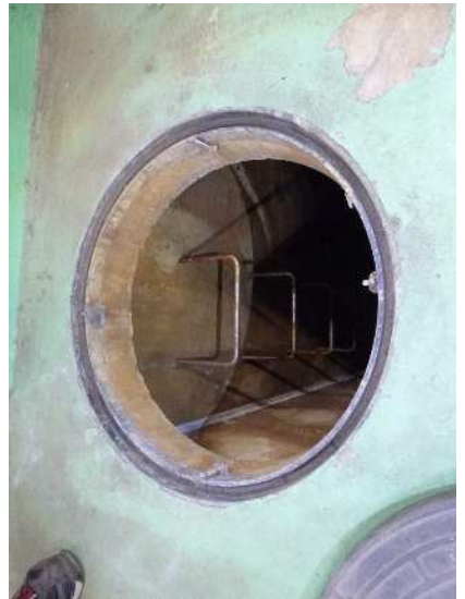
No. 1063 2階 処理室 活性炭処理水槽 マンホール (東側) マンホール枠に全体的な錆の発生がみられる。
