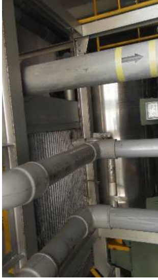
No. 2010 受入貯留設備 浄化槽汚泥用細目スクリーン 歩廊下部に腐食が見られるた め補修が必要。
