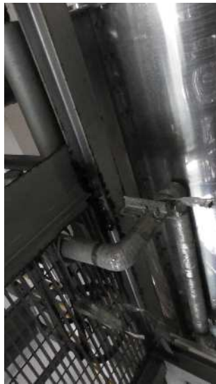
No. 2008 受入貯留設備 し尿用細目スクリーン (No.2) 歩廊下部に腐食が見られるた め観察が必要。
