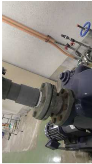
No. 2015 受入貯留設備 し尿攪拌ポンプ
