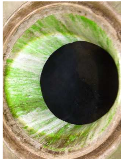
No. 1015 1階 投入室 し尿貯留槽 マンホール (投入室中央付近) マンホール枠と開口周囲の防食に汚損と劣化が見られる。
