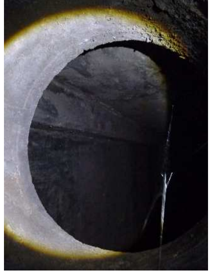
No. 1066 2階 処理室 消毒槽 水槽 水槽内に特に異常は見られない。
