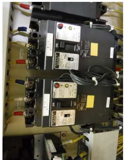
No. 3009 中央制御室 前処理・汚泥処理制御盤(4) 内部機器の耐用年数を考慮し作動確認の実施が必要。遮断器更新の検討が必要。
