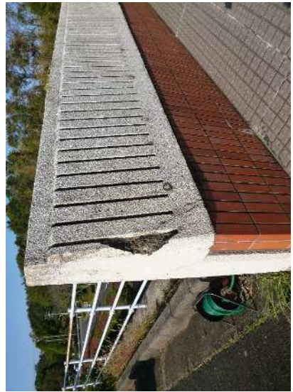
No. 1213 処理棟 屋外手摺壁 （玄関アプローチ） 手摺壁の割れや劣化が見られる。
