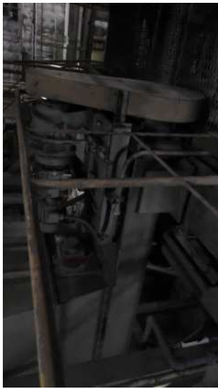
No. 2013 受入貯留設備 し渣ホップ
