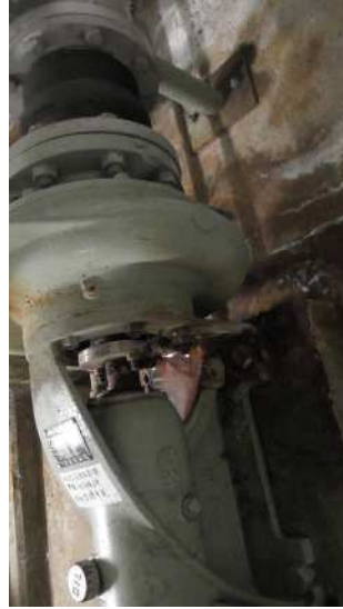
No. 2023 高度処理設備 逆洗ポンプ 本体に腐食が見られるため補修が必要。
