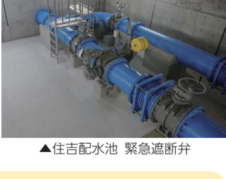
▲住吉配水池 緊急遮断弁
