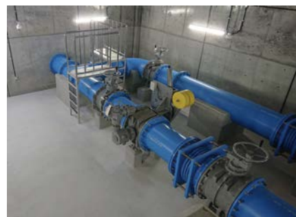
▲住吉配水池 緊急遮断弁
