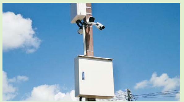
設置された防犯カメラ
