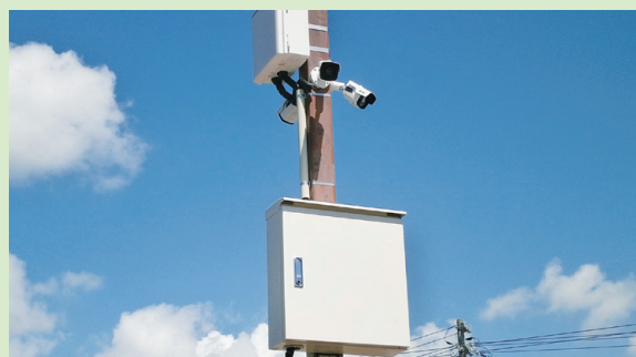
設置された防犯カメラ
