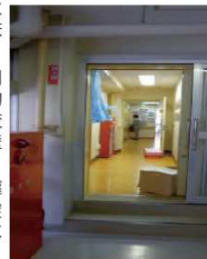
水回りのために床を高く整備するとともに、中学校との間に避難用の扉（防火扉）を設置
