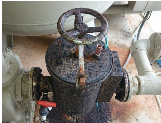
ろ過設備の腐食
