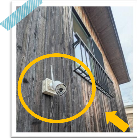
▲設置した防犯カメラ
