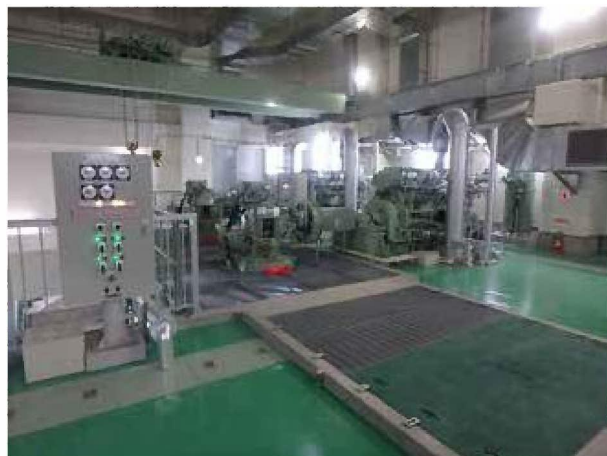
■ポンプ原動機室
