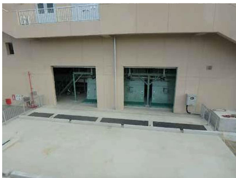
■沈砂機械設備
