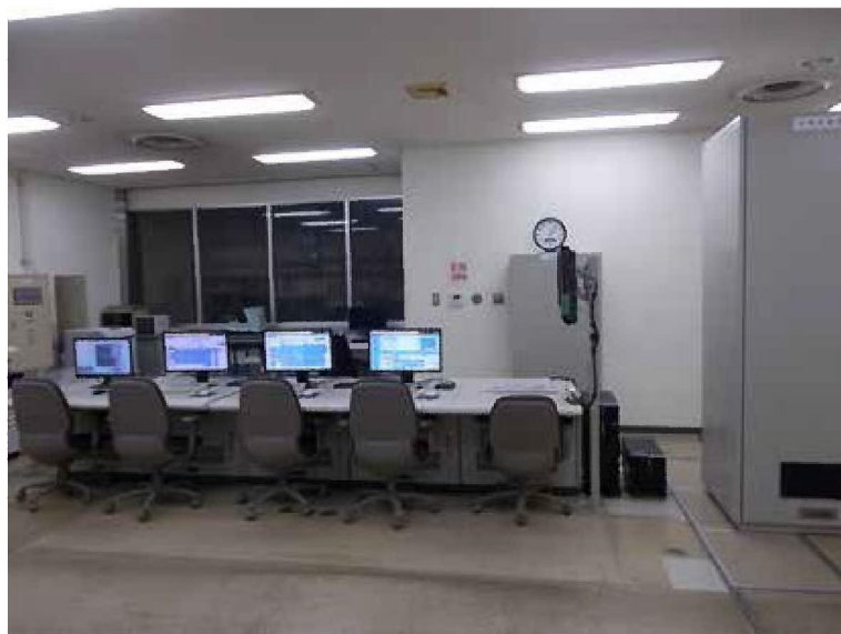
■江島雨水ポンプ場 監視室・制御盤
