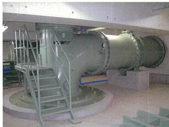
No.3, 4雨水ポンプ及び吐出管
