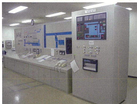
江島ポンプ場操作盤
