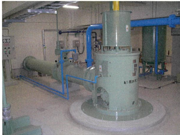
No. 1 雨水ポンプ及び吐出管
