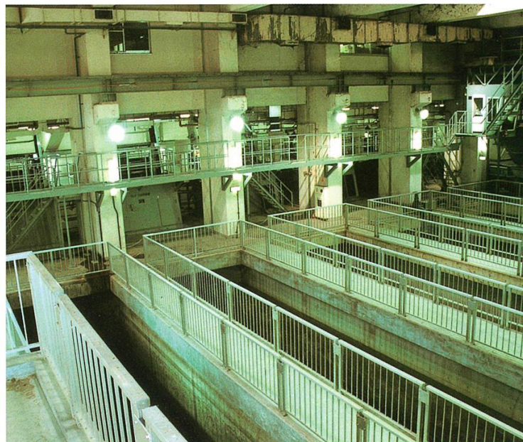
■ 沈砂機械設備
