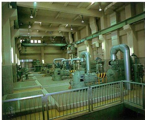
■ ポンプ原動機室
