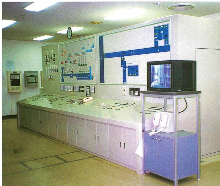
■ 監視室・制御盤
