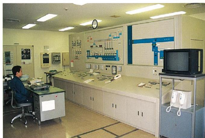
遠方操作監視室(江島雨水ポンプ場)
