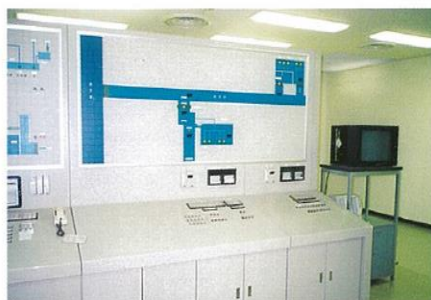
遠方操作監視室(江島雨水ポンプ場)
