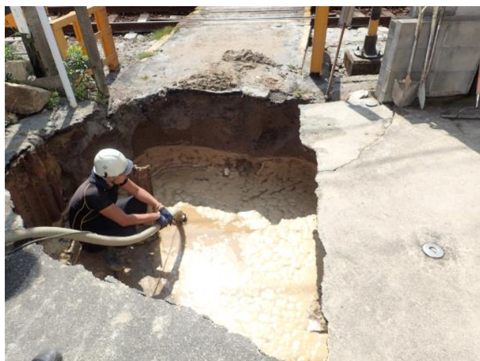
2016年5月に発生した近鉄軌道付近での漏水事故(長太地区)
