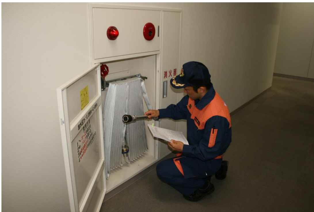
消防用設備検査
