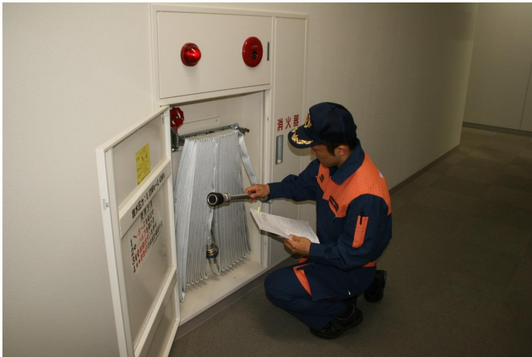
消防用設備検査
