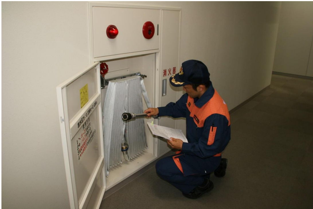
消防用設備検査
