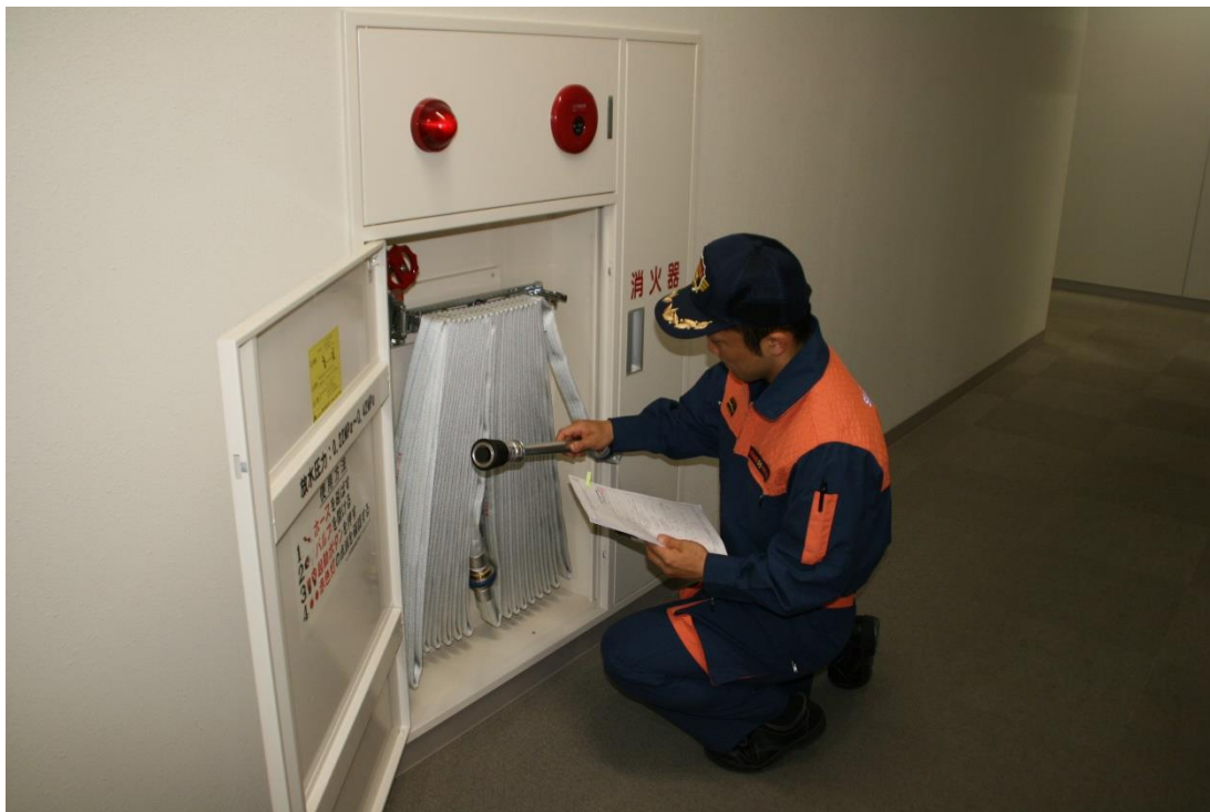
消防用設備検査
