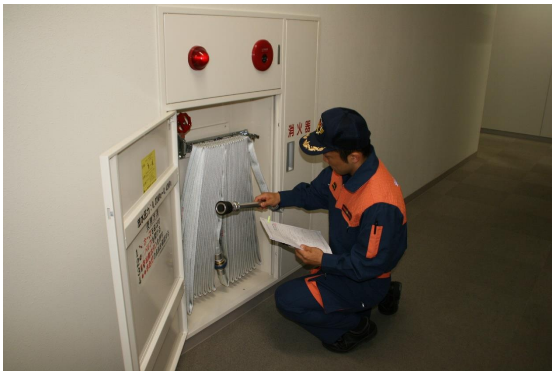
消防用設備検査
