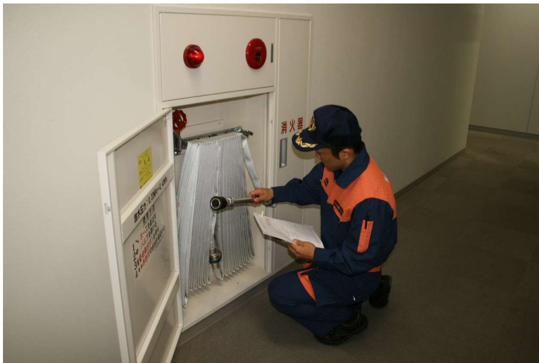
消防用設備検査
