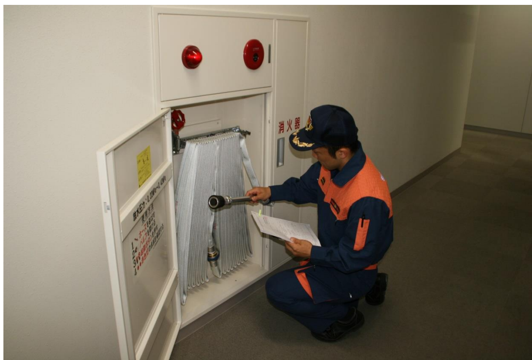
消防用設備検査
