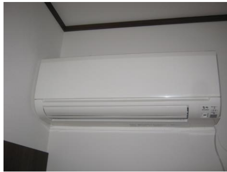
【付属設備 (エアコン)】
