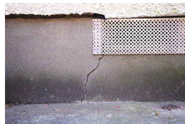
基礎のひび割れ
