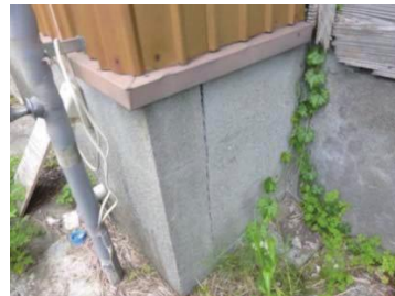
基礎の ひび割れ
