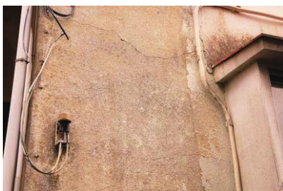
外壁のひび割れ ・コケ
