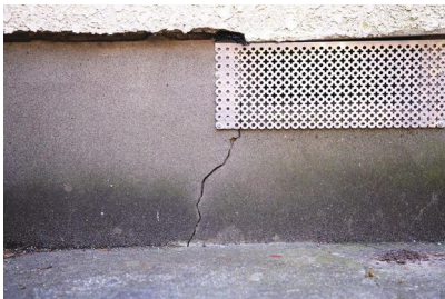
換気口付近の ひび割れ
