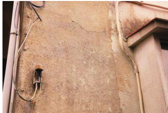
外壁のひび割れ・こげ
