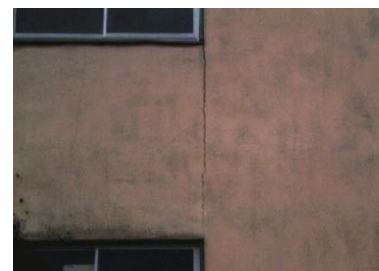
外壁の ひび割れ
