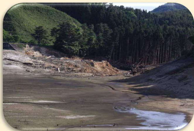
平成22年3月11日、東日本大震災により決壊した藤沼ダム(1,504千m3)
